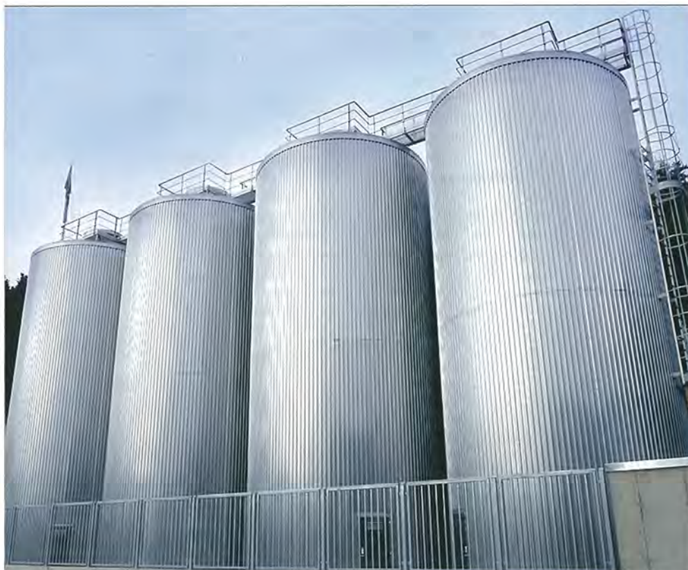
Die montierte Tankanlage in Bad Neuenahr umfasst vier Tanks mit je 300 m 3 Fassungsvermögen.
