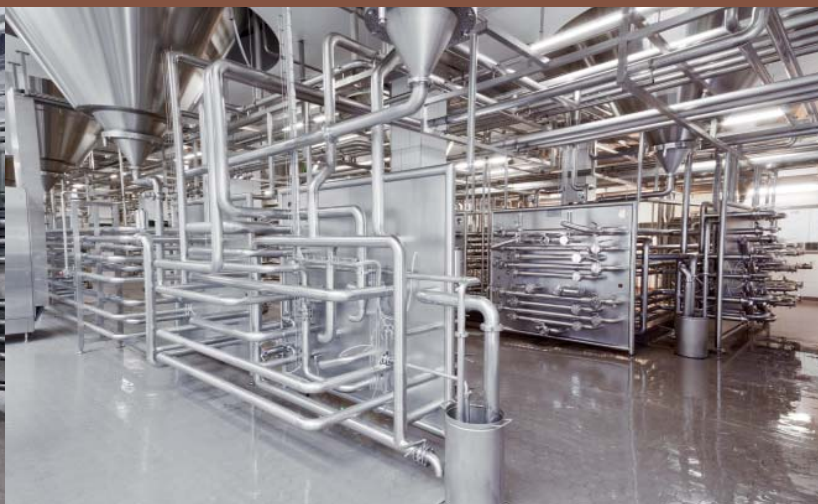
Die Rückansicht eines ZKT-Austrittspaneels
