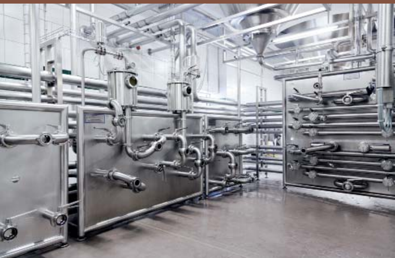
Das Zentralpanel zur Filtration mit automatischem Verschneidbock
