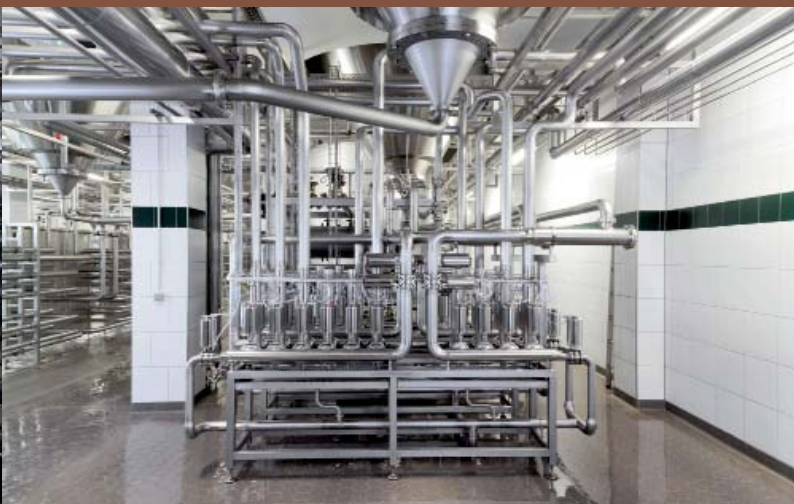
Der neue, vollautomatische Verteilknoten für CIP-Vor- und Rücklauf
