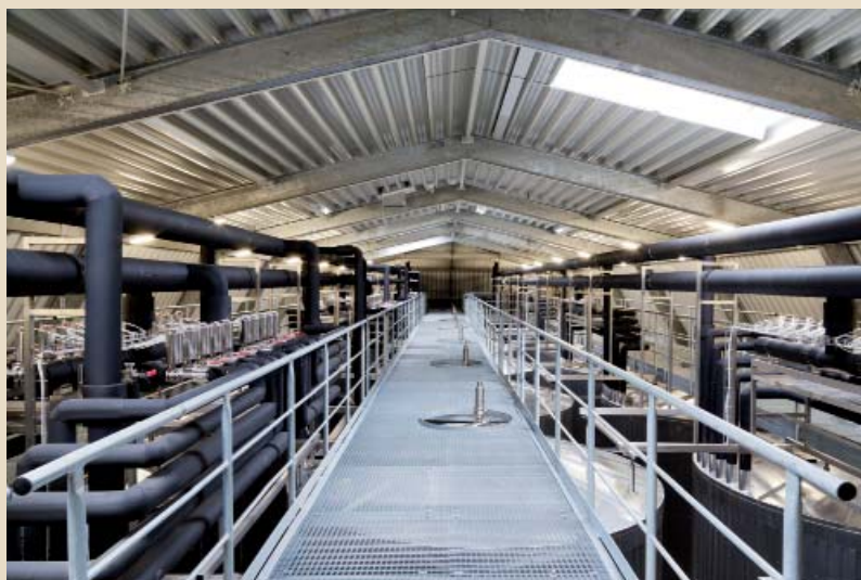
Ein Blick in das Dachgeschoss mit Wartungssteg und Glykol-Leitungen
