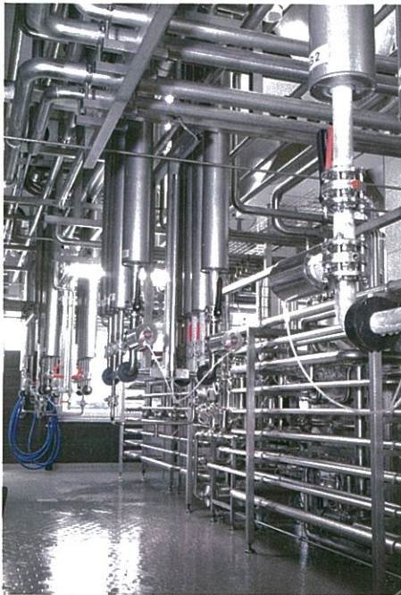
Glykolverteiler im ZKL-Keller
